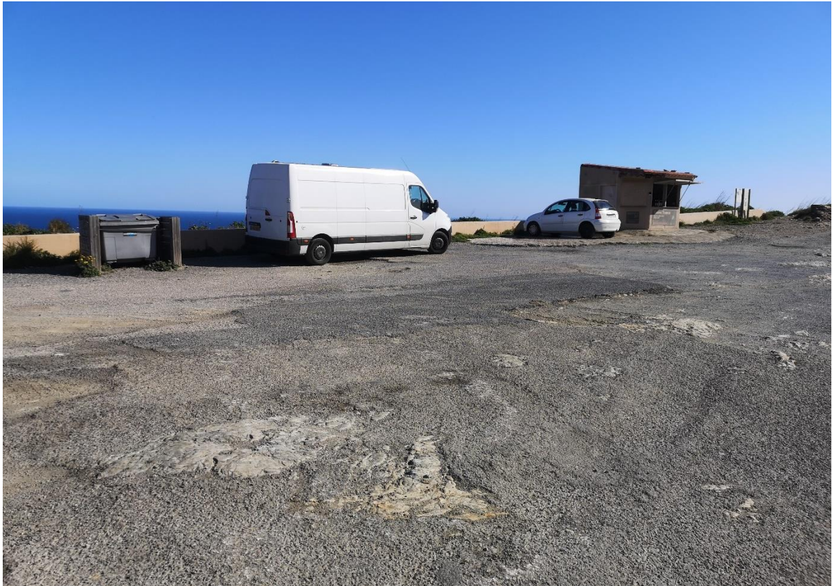
☞ Photographie 8 : Poubelle et stand de vente sur le belvédère, à noter l'état du revêtement au sol
