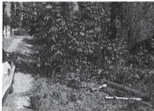
supports et glissières bois métal arrachés
