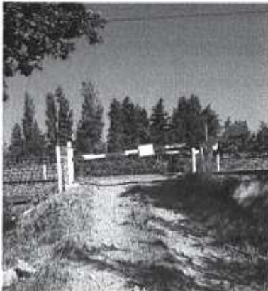
Vue depuis sud (barrière et support détériorés)
