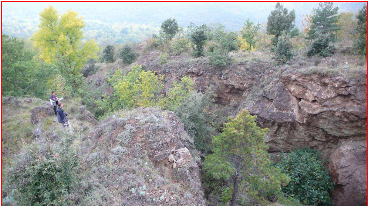
Site n° 388. Vernet-les-Bains. Concession de Saint-Vincent. Minières. Mines de fer de Vernet-Sahorre. Exemples de fronts rocheux. Juin 2007
