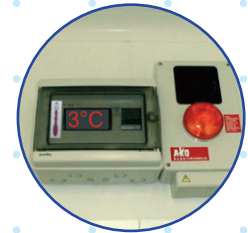
Surveillance des températures
