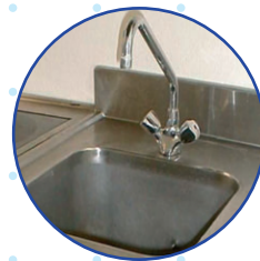
Evier alimenté en eau potable
