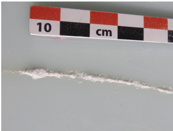
Détails d'efflorescences salines sur une fissure d'un carreau d'opaline
