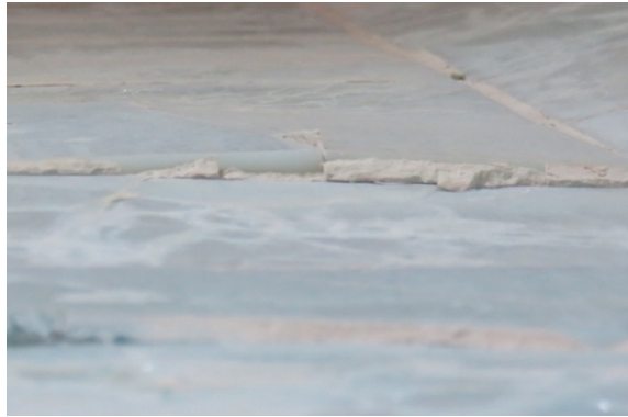
Détail d'un carreau déformé dépassant du plan du mur
