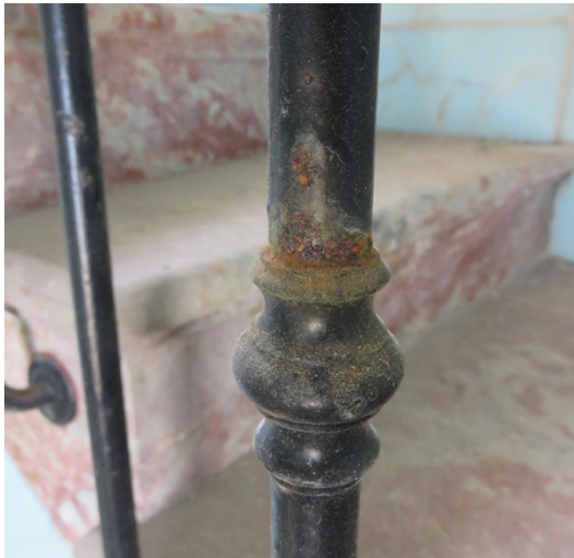
Détail d'une zone limitée d'oxydation de la tige en alliage ferreux dans la partie haute de la rampe
