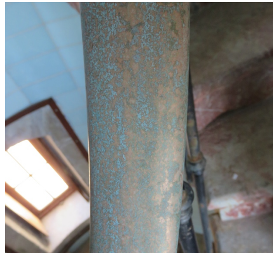
Détail de l'oxydation de surface sur la main courante de la rampe (localisation entre la première et la deuxième fenêtre côté porte du phare)
