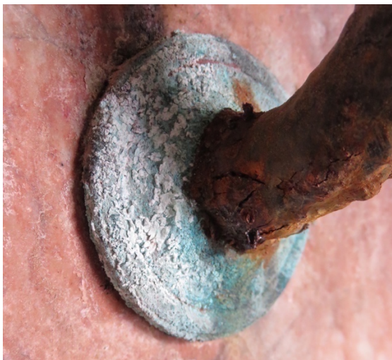
Détail de la forte oxydation et de la corrosion active sur la rondelle en alliage cuivreux et de la tige en alliage ferreux de la rampe métallique (localisation RDC du phare).
