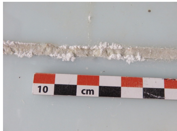
Détails d'efflorescences salines sur un joint entre 2 carreaux d'opaline
