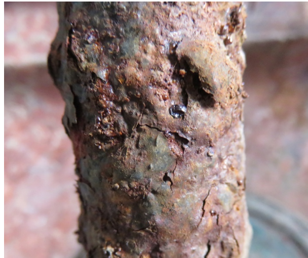
Détail de la surface fortement altérée de la tige en alliage ferreux. Gouttelettes, fissurations et feuilletages caractéristiques d'une corrosion active du fer (localisation RDC du phare).
