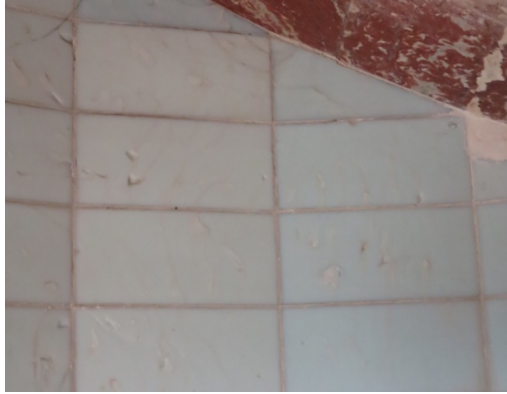
Vue des différences de couleur entre les carreaux sous l'escalier en RDC
