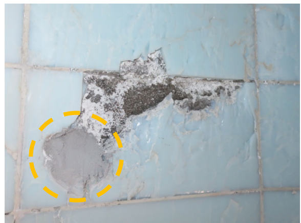
Détail d'un carreau cassé avec une zone de carottage bouchée au mortier gris (cerclé en pointillé jaune)
