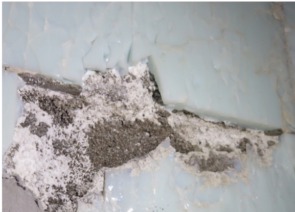
Vue d'une grande zone de lacune avec mortier sous-jacent apparent et efflorescences de sels
