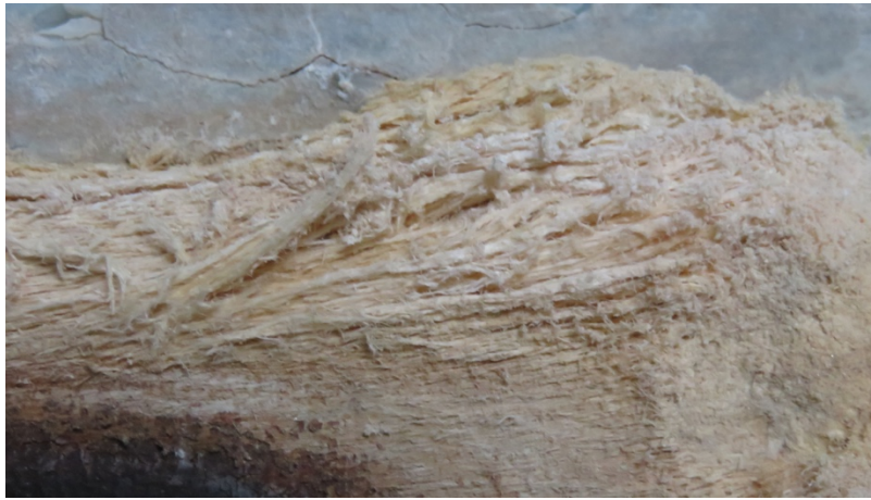
Détail des fibres de bois n'ayant plus de tenue structurale
