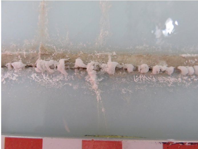
Détail des cristallisations à l'interface carreau/joint
