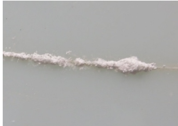
Vue des efflorescences salines le long d'une fissure dans l'opaline
