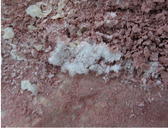
Détails d'efflorescences salines sur le marbre
