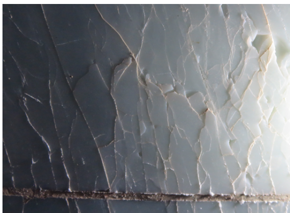
Détail d'un réseau de fissures en lumière rasante, des morceaux sont déjà saillants par rapport à la surface
