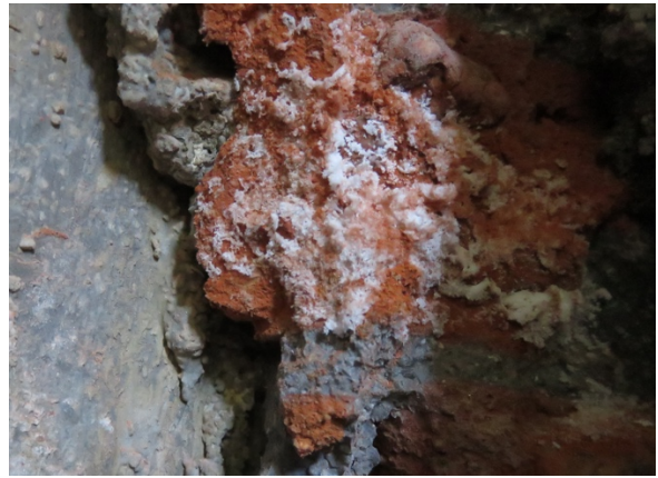
Détails d'efflorescences salines sur la brique
