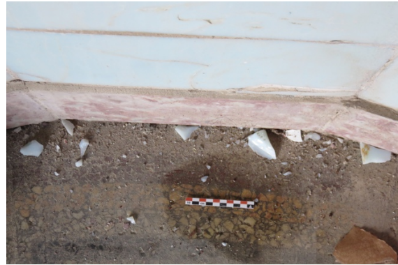
Vue du sol du RDC du phare avec les fragment d'opaline tombés
