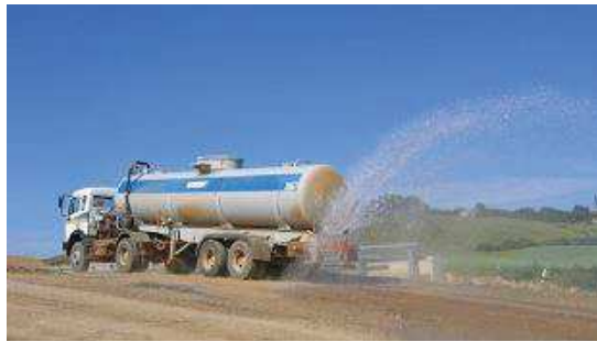
Exemple de camion citerne d'arrosage utilisé sur des chantiers pour l'arrosage des pistes circulées (chantier A9 – Anne Scher)
