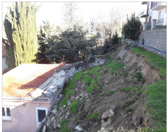
Codalet. Glissement de terrain de 200 m 3 déclenché à la suite de la tempête GLORIA de janvier 2020 au sein d'un quartier urbanisé. RTM
