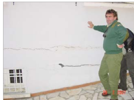
Reynès. Fissuration d'une maison d'habitation à cause du retrait/gonflement des argiles (RTM, 2007)
