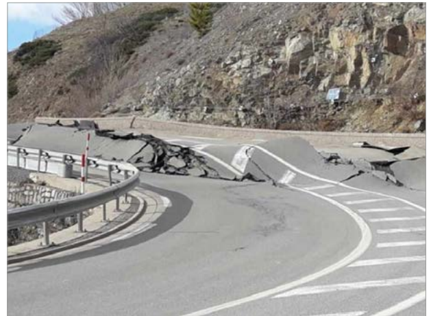
RN116. Glissement de terrain de versant d'un volume estimé à 500 000 m 3 déclenché sur les pentes du Pallat entre Fontpédrouse et Sauto soulevant la chaussée de la RN116 qui resta fermée plus de 3 mois. RTM
