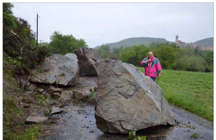
Eus. Chute de 3 gros blocs en avril 2020 sur la RD35 entre Marquixanes et Eus. RTM
