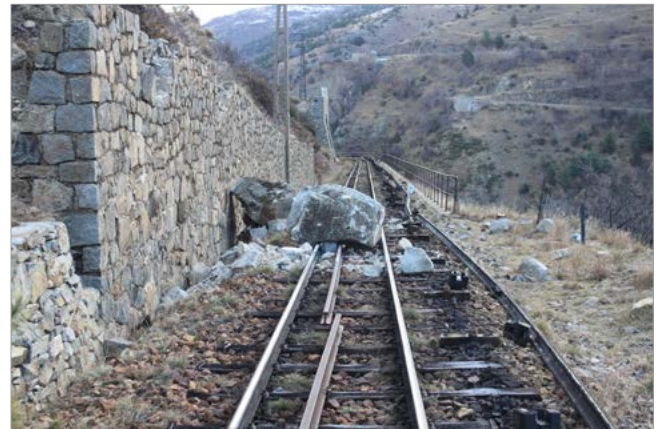
Fontpédrouse. Chutes de blocs sur la voie ferrée du train jaune et sur la RN116 (RTM 2017)
