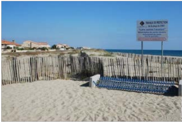
Réhabilitation douce du cordon dunaire au Barcarès par la pose de ganivelles © DREAL Occitanie
