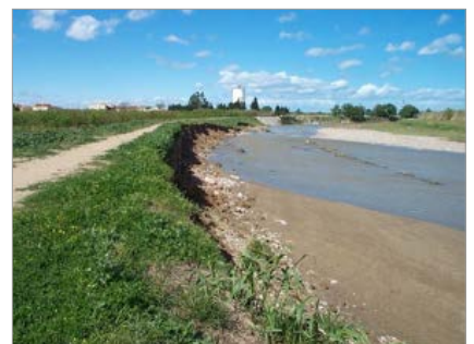
Saleilles – Réart (glissement du talus de digue côté cours d'eau)
