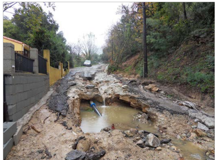
SOREDE. Ruissellement pluvial provenant des versants et canalisé sur la chaussée dans le lotissement de la Vallée Heureuse à Sorède. La voirie a été complètement creusée laissant apparaître les réseaux sous chaussée (RTM, 2011)
